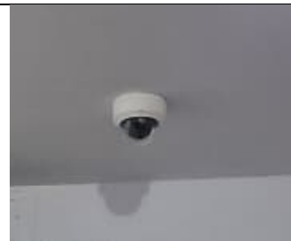
Terdapat CCTV di gudang
